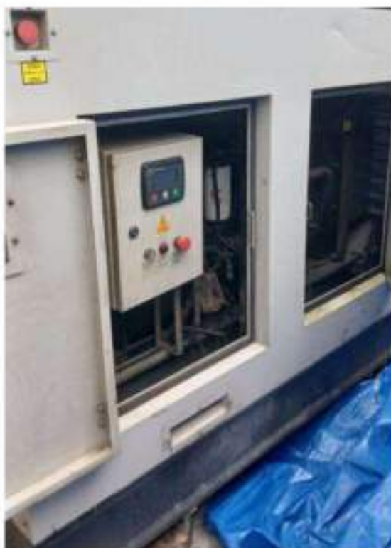
GERADOR COM MOTOR YANMAR
