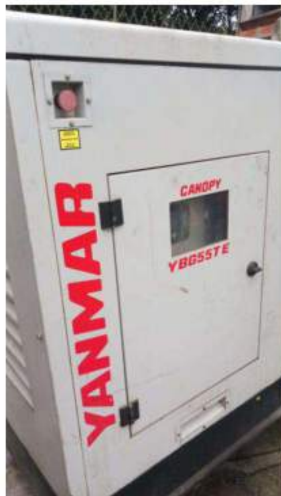
GERADOR COM MOTOR YANMAR
