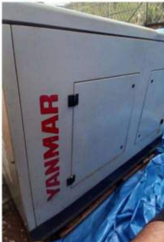
GERADOR COM MOTOR YANMAR
