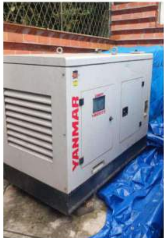
GERADOR COM MOTOR YANMAR
